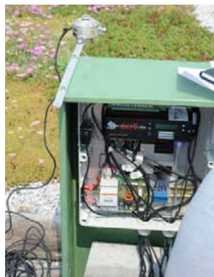
Figura 12 la centralina del campo di prova
